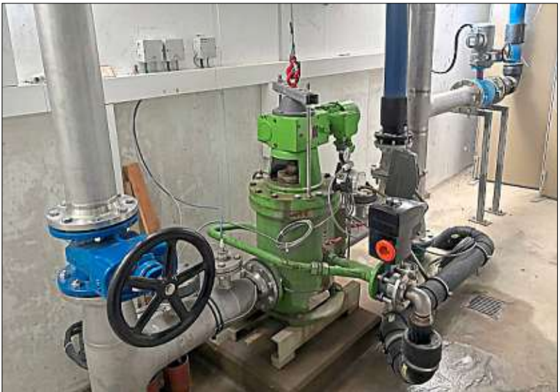
Die erste Station des abgepumpten Flusswassers: In diesem Meeresfilter wird der Schlamm und Sand des Inn herausgefiltert. – Fotos: Krenner
