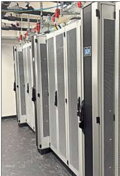
Ein mögliches Ziel: Die Uni-Server müssen ganzjährig gekühlt werden.
