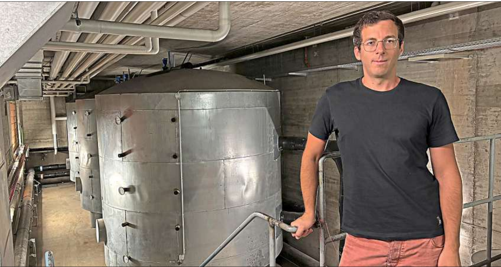
Lüftet die Geheimnisse hinter dem Kühlsystem und führt dafür durch das Labyrinth der Leitungen: Thomas Schmidbauer hat vor zwei Jahren die fachliche Leitung der Betriebstechnik der Universität Passau übernommen. Hier steht er vor den Pufferspeichern, die Energie zwischenspeichern.
