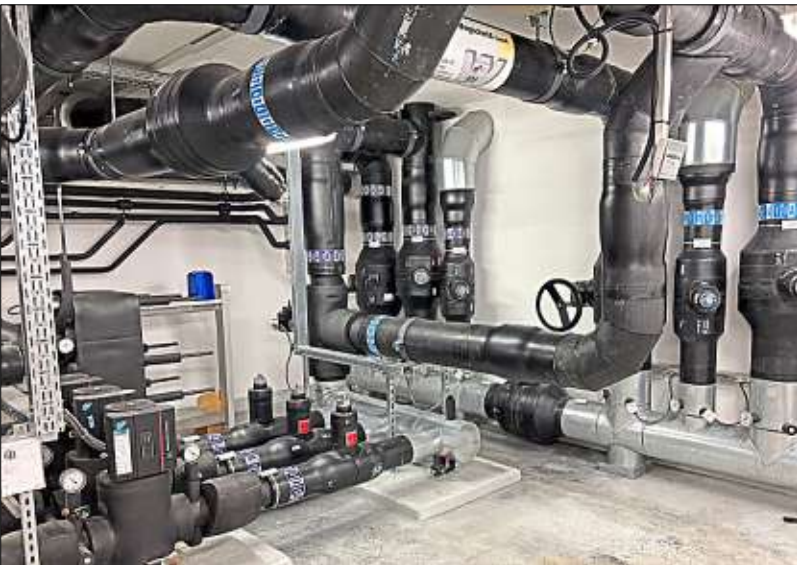
Hier läuft alles zusammen: Im zentralen Kältenetzraum kommt unter anderem der vom Inn gekühlte Kältenetzrücklauf an und wird weiter verteilt.
